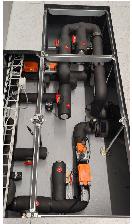
DLC versatile CDU provisioning
